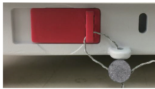
Bloqueado con cable de sellado
